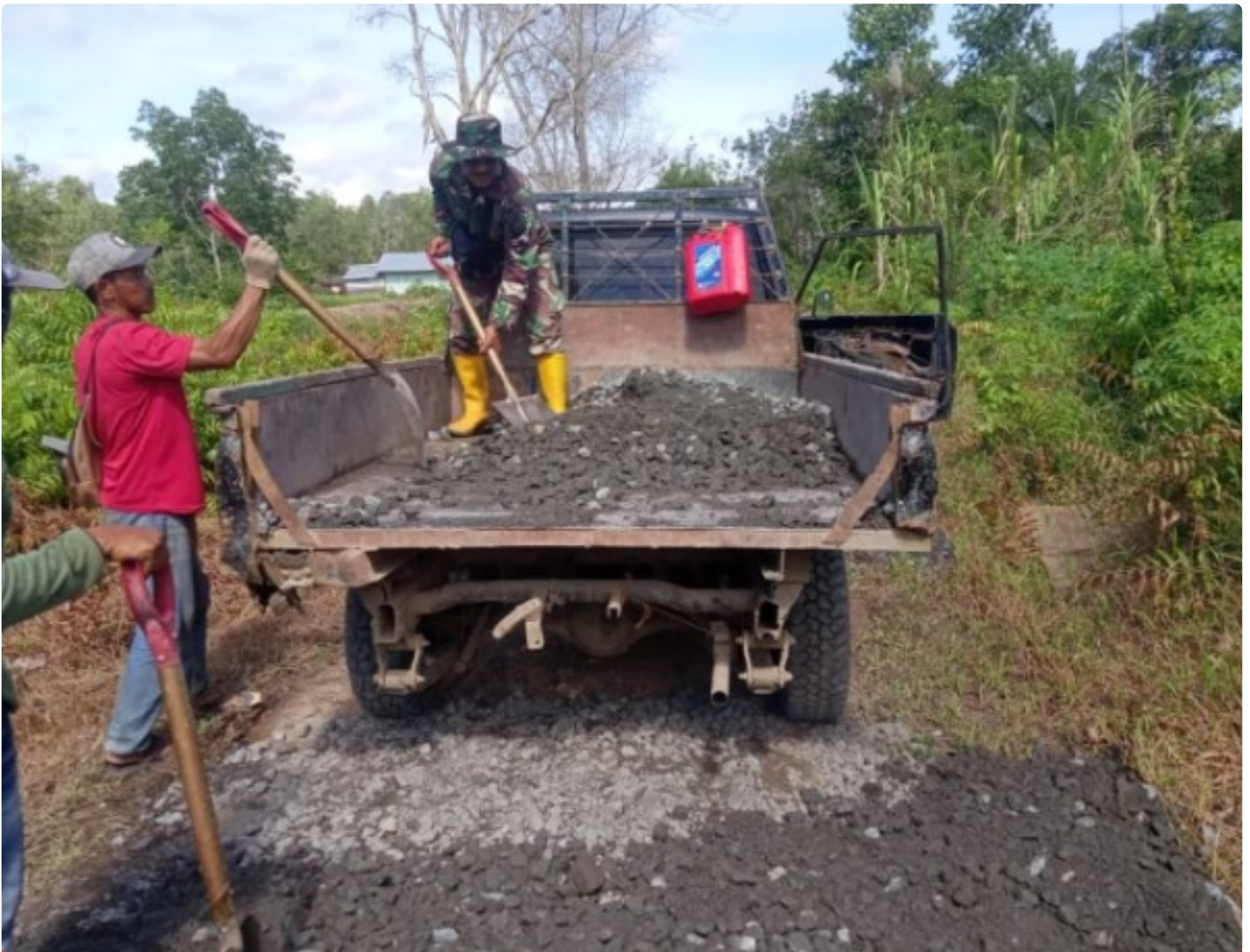
Pengerasan Jalan, Satgas TMMMD ke-113/Kodim 1005/Barito Kuala dan Warga Ratakan Material Dengan Cangkul
